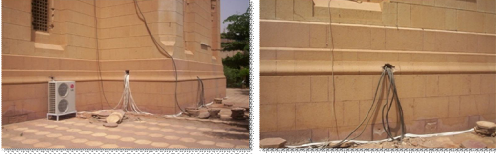
إنشاء توصيلات للمبنى بصورة عشوائية-المصدر: الإدارة العامة للآثار والمتاحف، ٢٠١٢م شكل (٨-٦٠) التشوهات في مسجد فاروق (أرباب العقائد)
